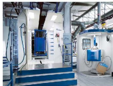
Mit der neuen Schnellfarbwechselkabine hat die Oberflächentechnik Löningen GmbH die Beschichtungsqualität erhöht und Farbwechselzeiten von 2,5 h auf 10 min reduziert. Fotos: Nordson
