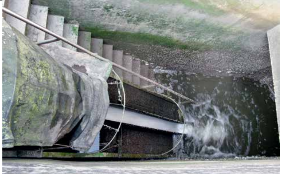
Abb. 5: Aufstiegsanlage für Glasaale am Wehr der Vilaine
