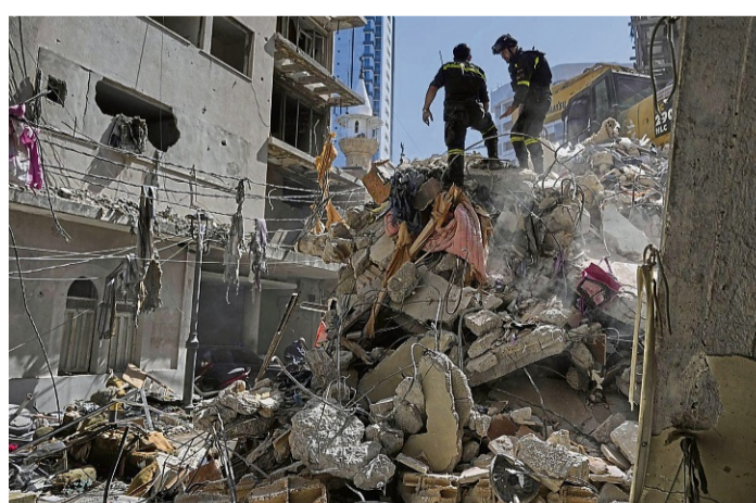
Ein israelischer Luftangriff zerstörte dieses Gebäude in Beirut. Mitarbeiter des Zivilschutzes untersuchen die Trümmer. DPA
